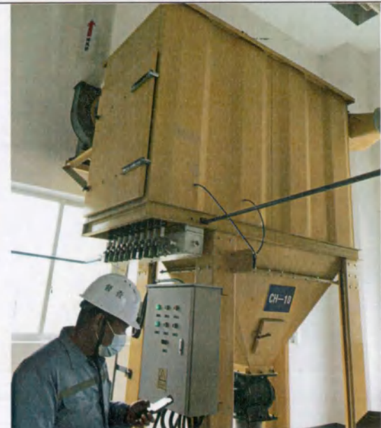
DA009 废气处理措施
