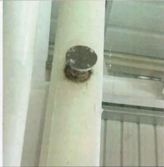
DA010 废气处理后采样口
