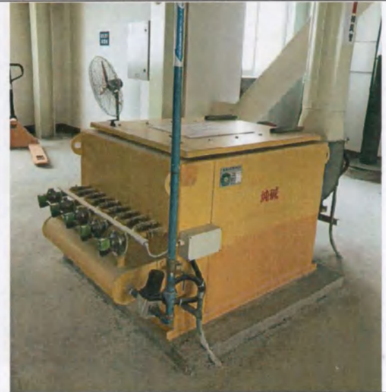
DA014 废气处理措施-袋式除尘器
