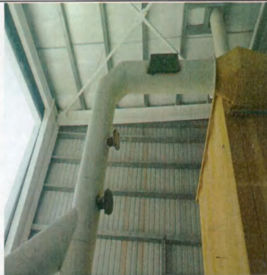
DA007 废气处理前采样口
