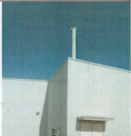
DA007 废气排放口
