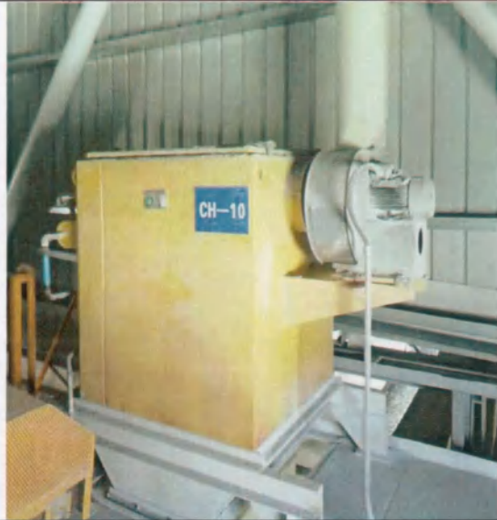
DA010 废气处理措施-袋式除尘器
