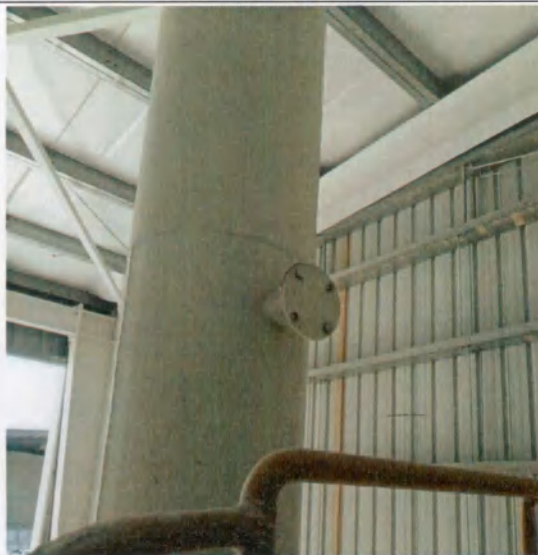
DA007 废气处理后采样口
