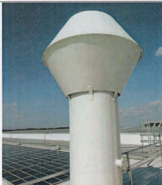
DA008 废气处理后采样口
