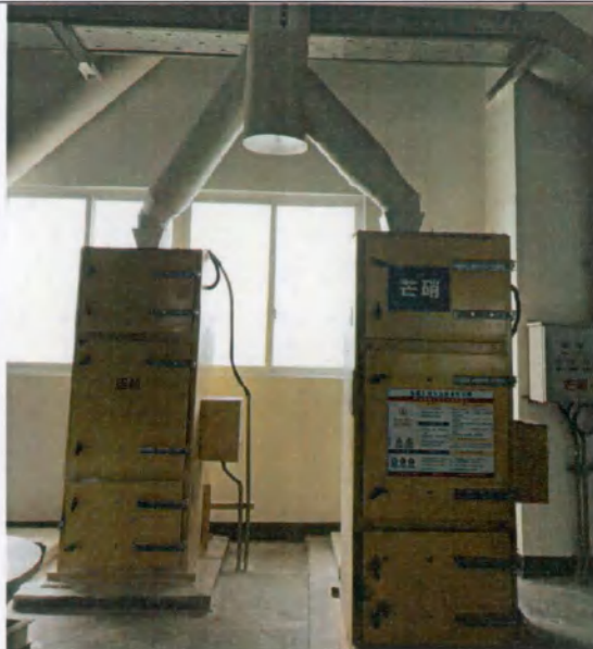
DA011 废气处理措施-袋式除尘器
