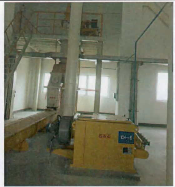
DA012 废气处理措施-袋式除尘器
