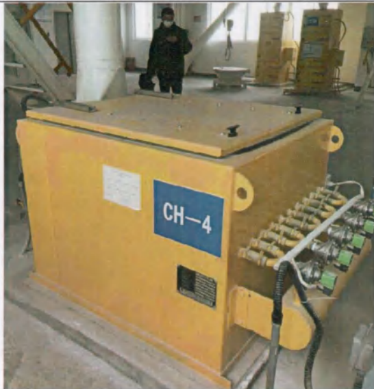
DA013 废气处理措施-袋式除尘器
