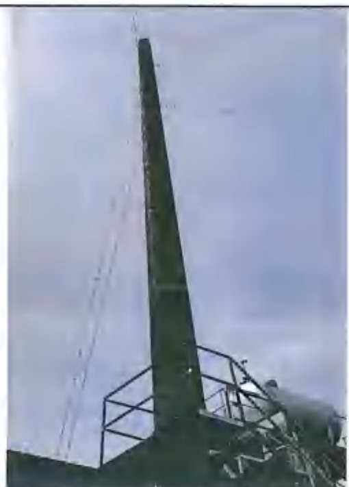
锅炉废气排放口 (FQ-00370)
